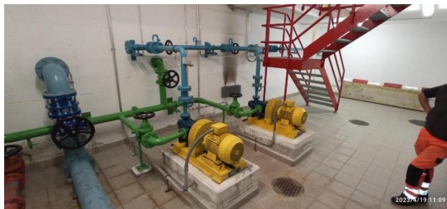
foto pompe stazione Brocchi
